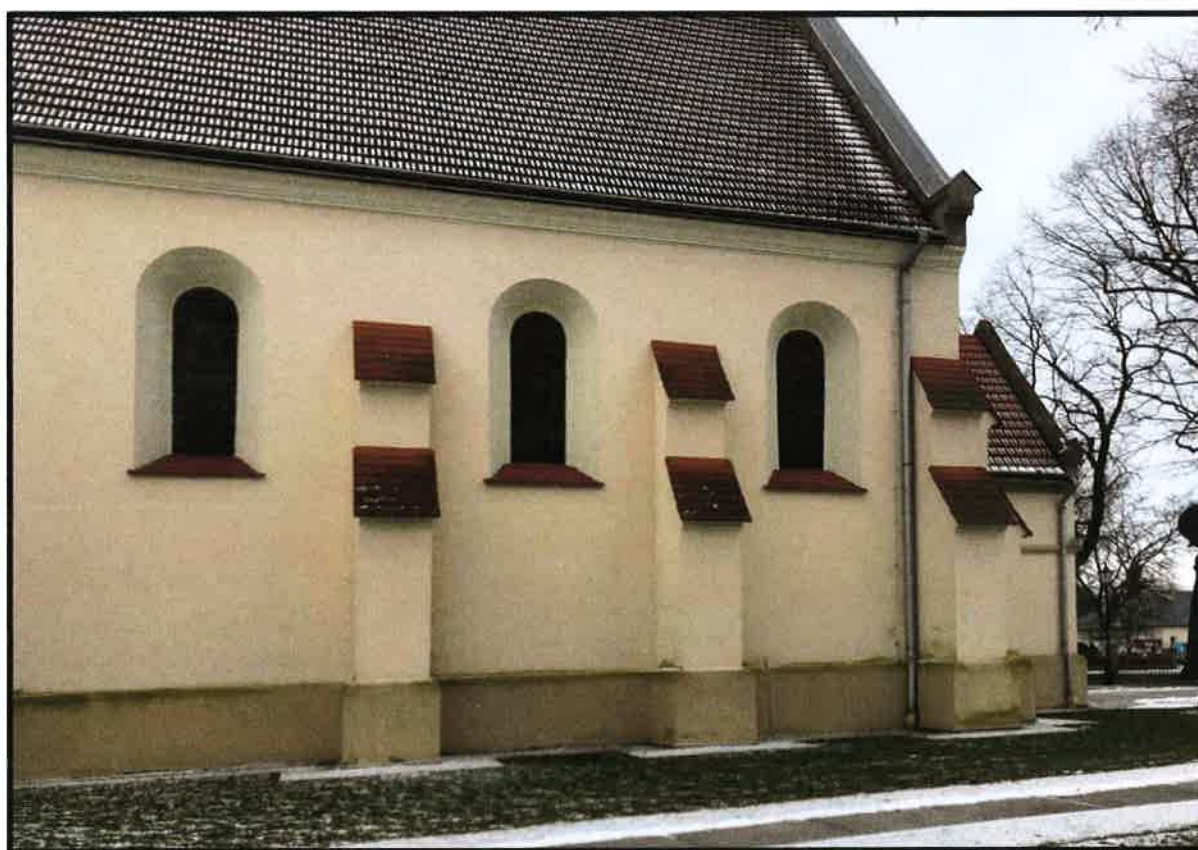
Stan techniczny cokołu - widoczne pleśnie i gorosty, tynk miejscami wykruszony,
